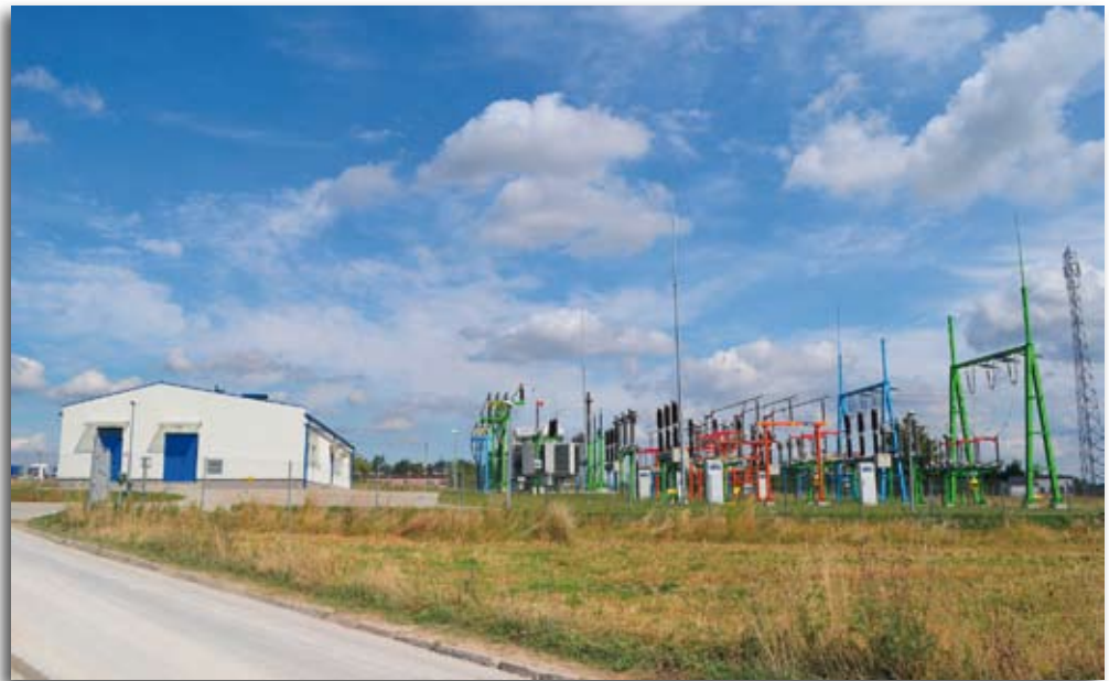
Stacja Głównego Punktu Zasilania Energetycznego w Owadowie
