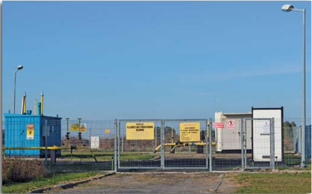
Stacja redukcji gazu w Grzżowicach
