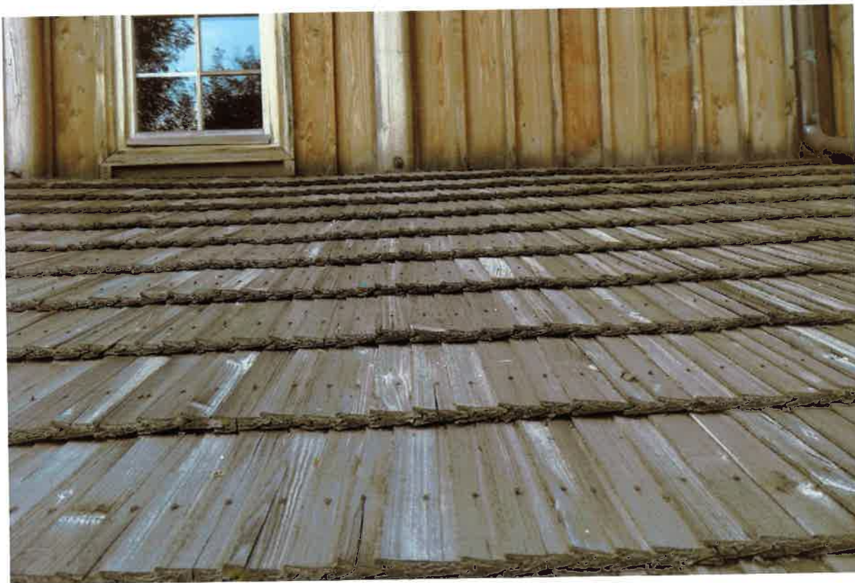
6. Nawa boczna. Strona północna. Stan zachowania gontów.
