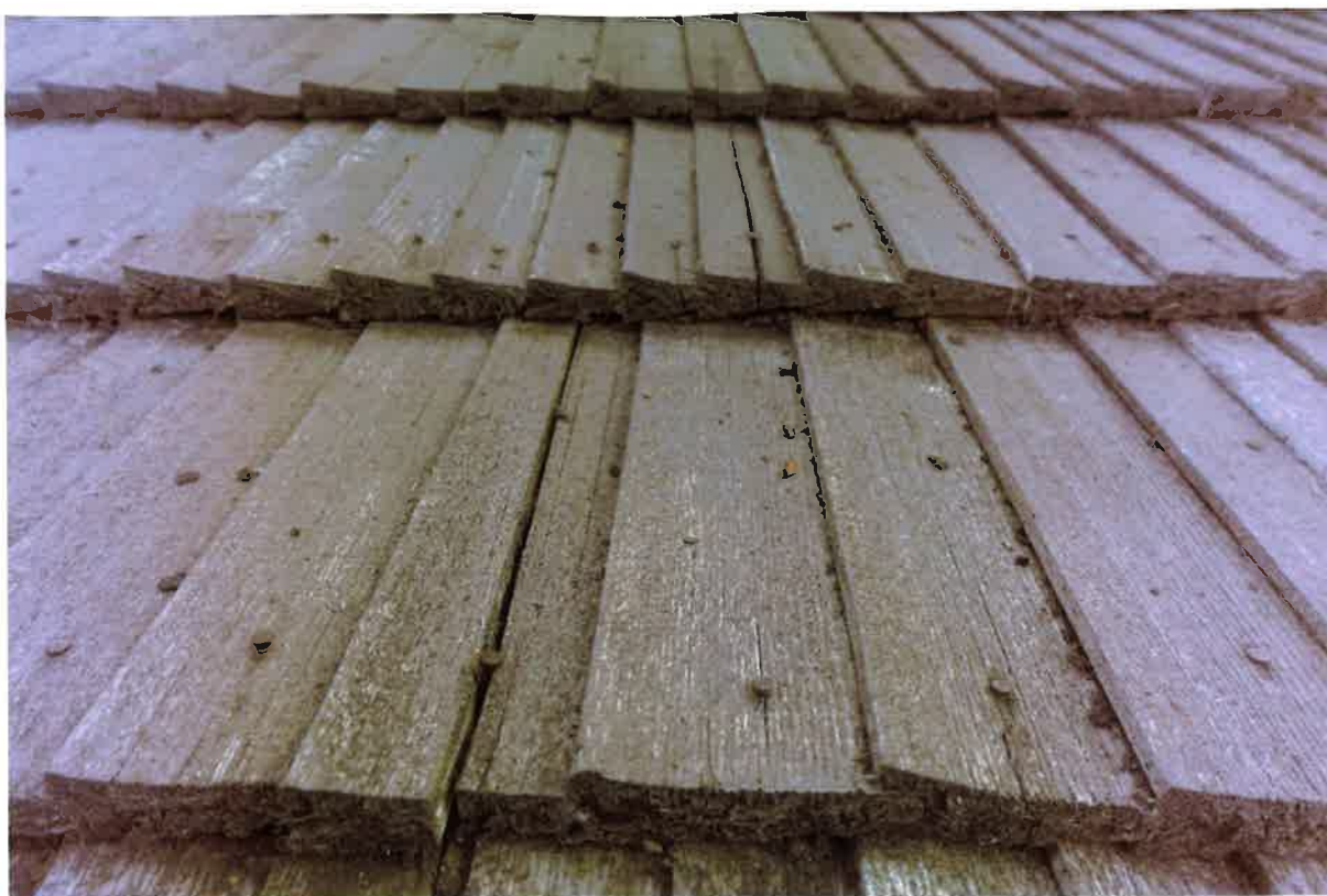
9. Nawa boczna. Strona północna. Stan zachowania gontów.
