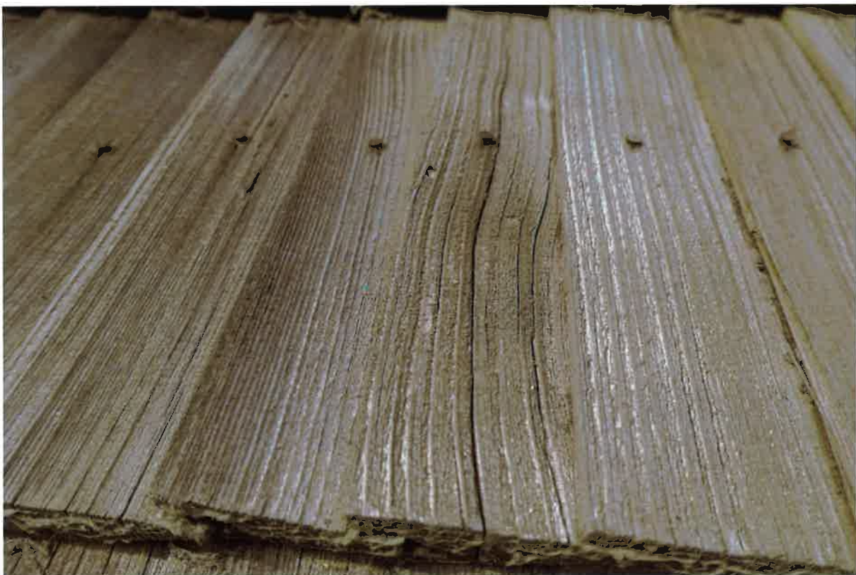
4. Nawa boczna. Strona południowa. Stan zachowania gontów.
