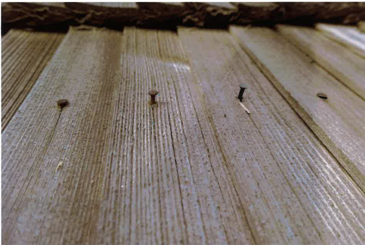
2. Nawa boczna. Strona południowa. Stan zachowania gontów.
