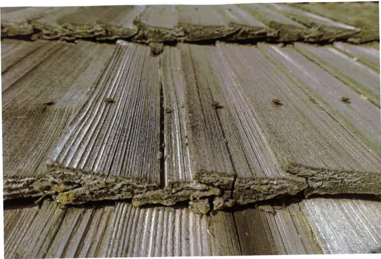
5. Nawa boczna. Strona południowa. Stan zachowania gontów.
