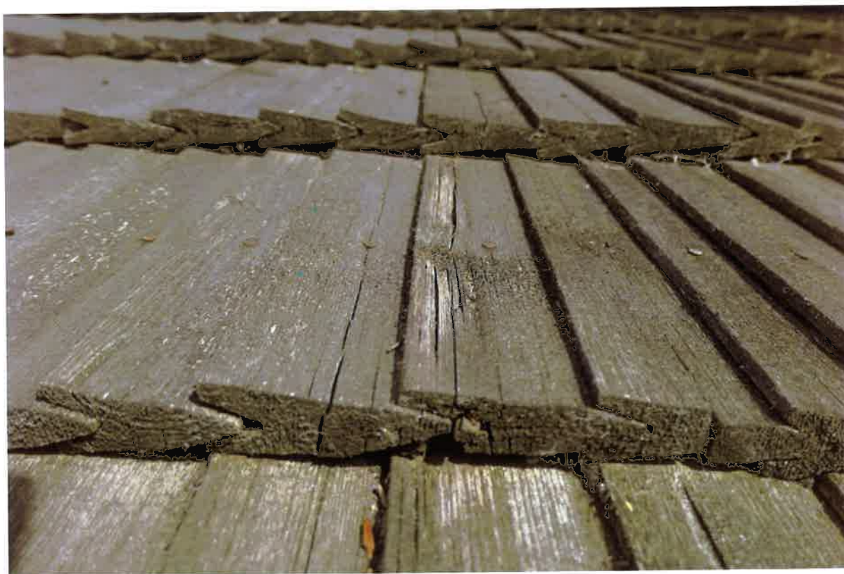
8. Nawa boczna. Strona północna. Stan zachowania gontów.
