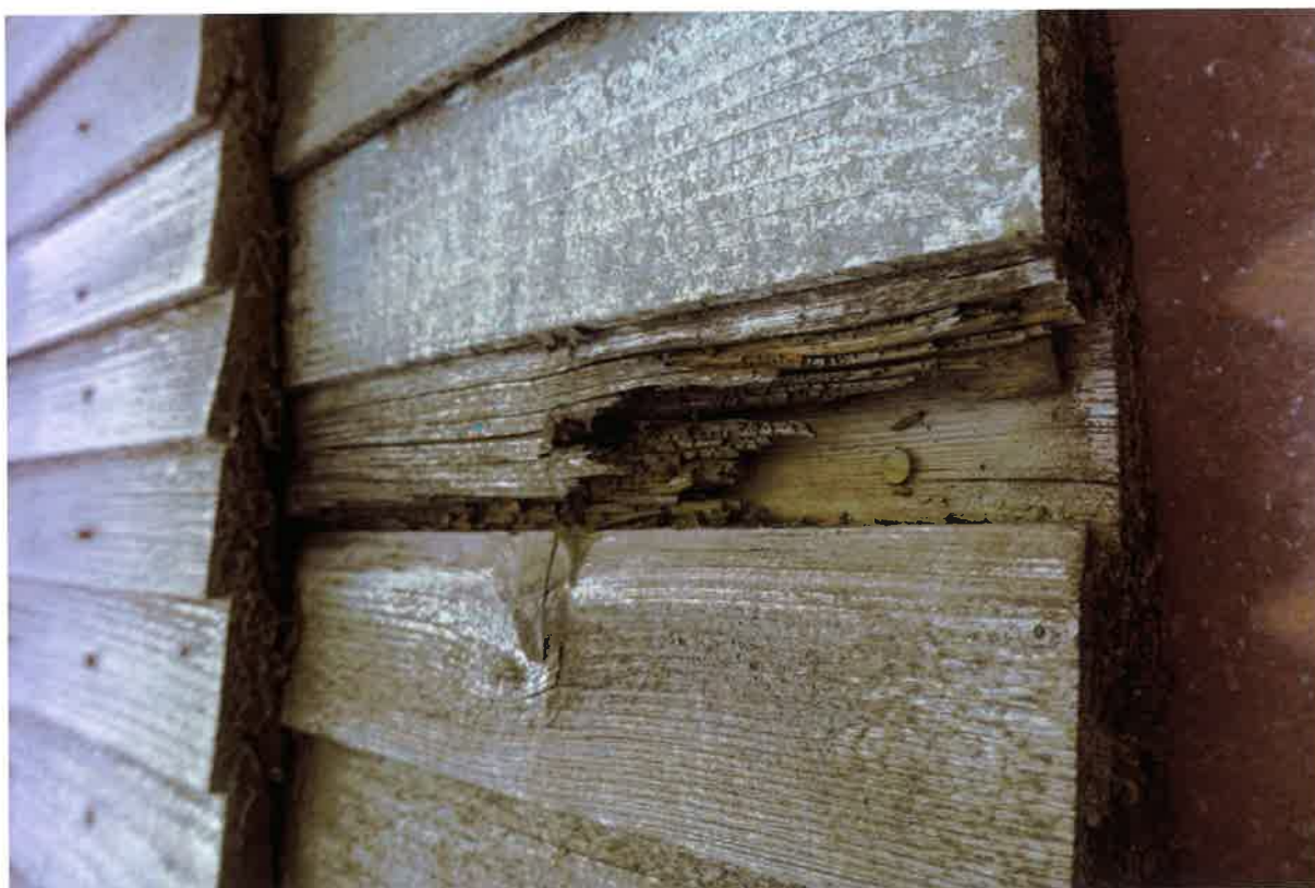
10. Nawa boczna. Strona północna. Stan zachowania gontów.
