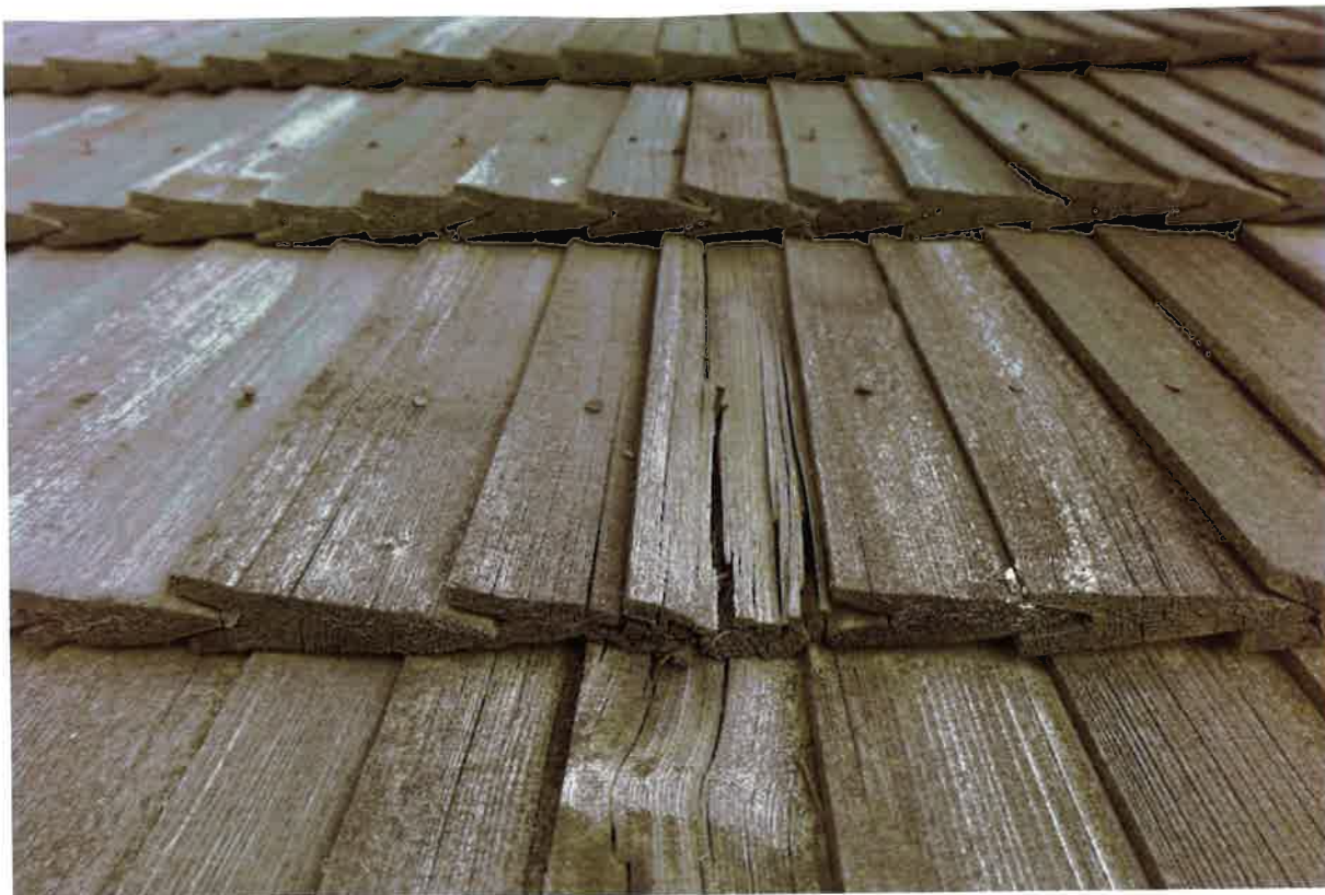
7. Nawa boczna. Strona północna. Stan zachowania gontów.
